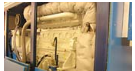
Detail des Blockheizkraftwerks bei der KSK Wesermündel-Hadeln in Bremerhaven (elektrische Leistung 64 Kilowatt)
