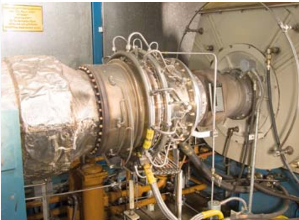
Gasturbine in der Betriebsstätte Bremen-Hemelingen von Kraft Foods Deutschland mit einer elektrischen Leistung von 1.125 Kilowatt
