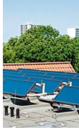
Solarkollektoren auf dem Dach des Stiftungsdorfes Osterholz
