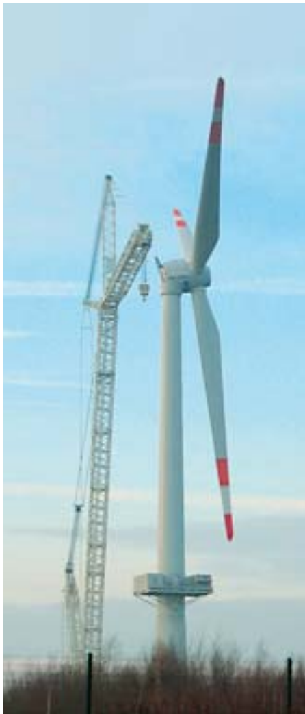
Erste Offshore-Testanlage in Bremerhaven
