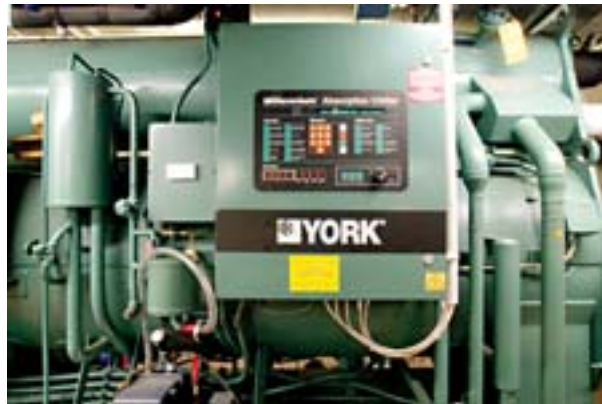
Absorptionskältemaschine in der Kreissparkasse Wesermünde-Hadeln in Bremerhaven
