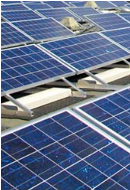
PV-Anlage auf einem Gebäude des Schulzentrums Drebberstraße
