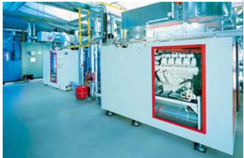
Blockheizkraftwerk (elektrische Leistung maximal 200 Kilowatt)
