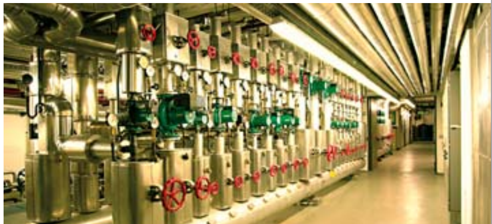
Wärmeverteilungseinrichtungen in der Heizzentrale des Klinikums Bremerhaven-Reinkenheide
