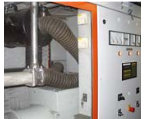
Blockheizkraftwerk im Stiftungsdorf Rönnebeck der Bremer Heimstiftung (elektrische Leistung 100 Kilowatt)
